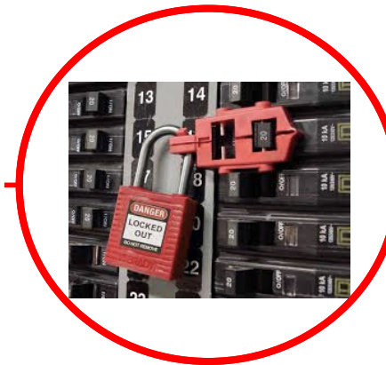
Uso exclusivo para control de energías
